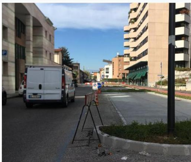
Via Cengio dalla giornata di oggi rischia il caos con la chiusura del parcheggio Europa e i lavori in corso
